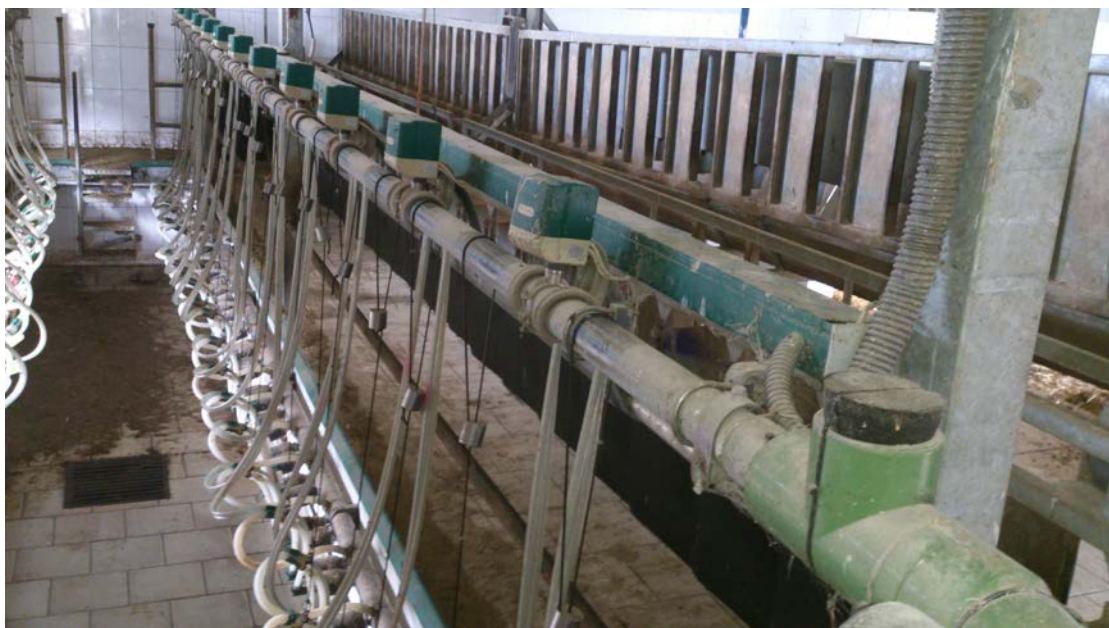
Εικ.58 Το αρμεκτικό συγκρότημα της μονάδας .
