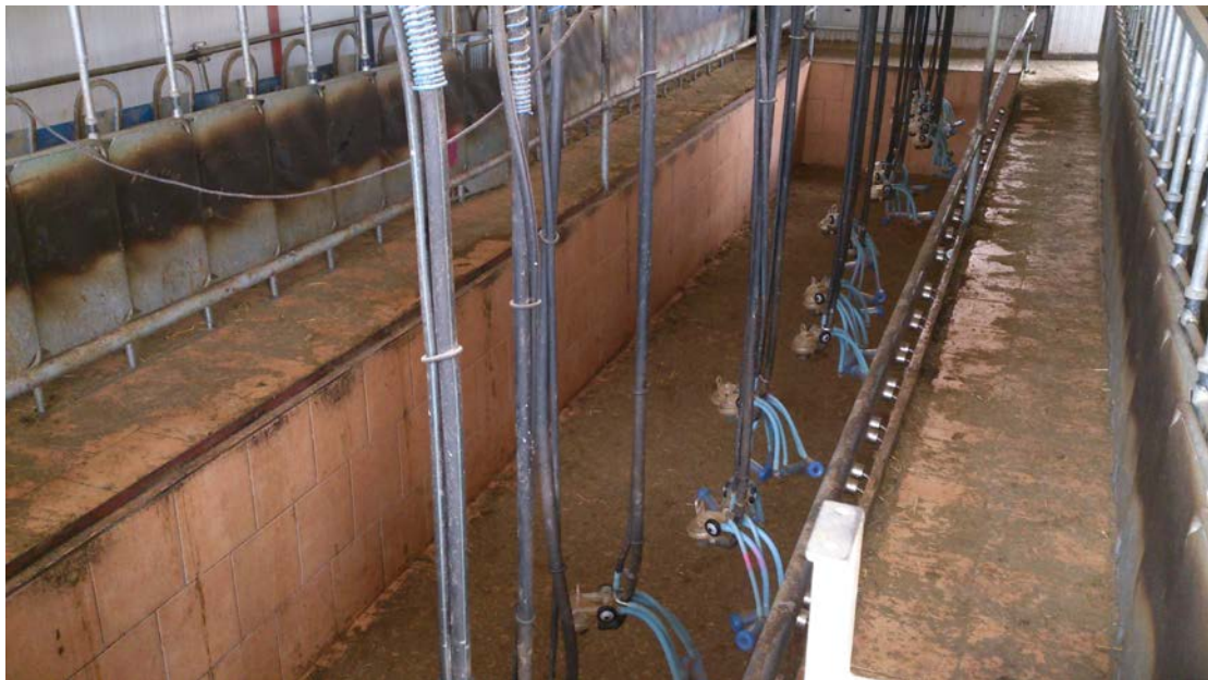
Εικ.44 Το αρμεκτικό συγκρότημα της μονάδας.
