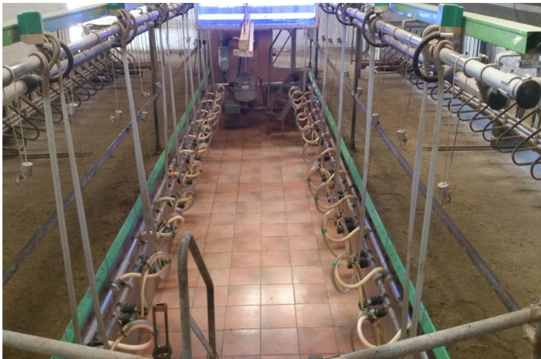
Εικ. 36 Το εσωτερικό του αρμεκτηρίου της εκμετάλλευσης.
