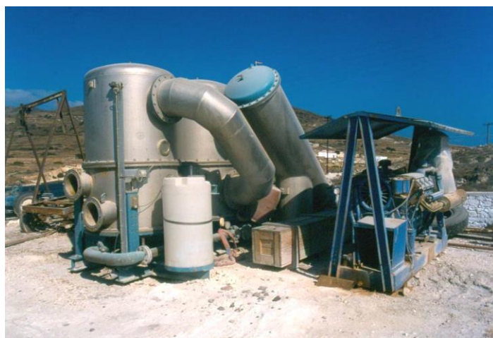
Αφαλάτωση νερού στην Κίμωλο(Ν. Ανδρίτσος)
