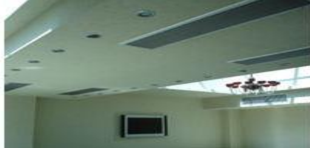
Fan coils ενσωματωμένα στην οροφή
