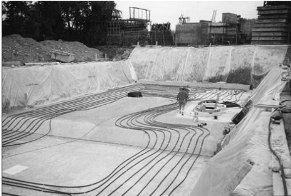
εγκατάσταση εναλλάκτη νερού / εδάφους
