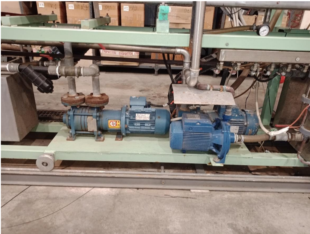
Εικόνα 3-13 Συγκρότημα αντλιών νερού και Vacuum
