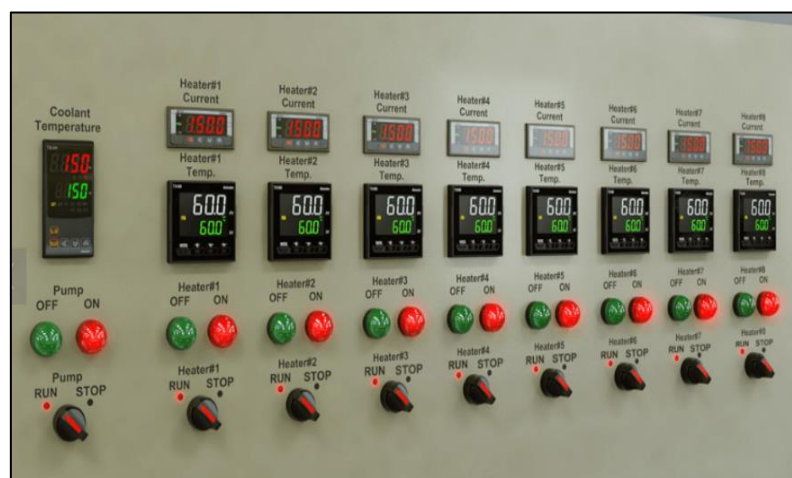
Εικόνα 3-5 Πίνακας ελέγχου ζωνών με Controllers (Πηγή : ( https://www.autonics.com/industry/view/MM/185 , n.d.)
