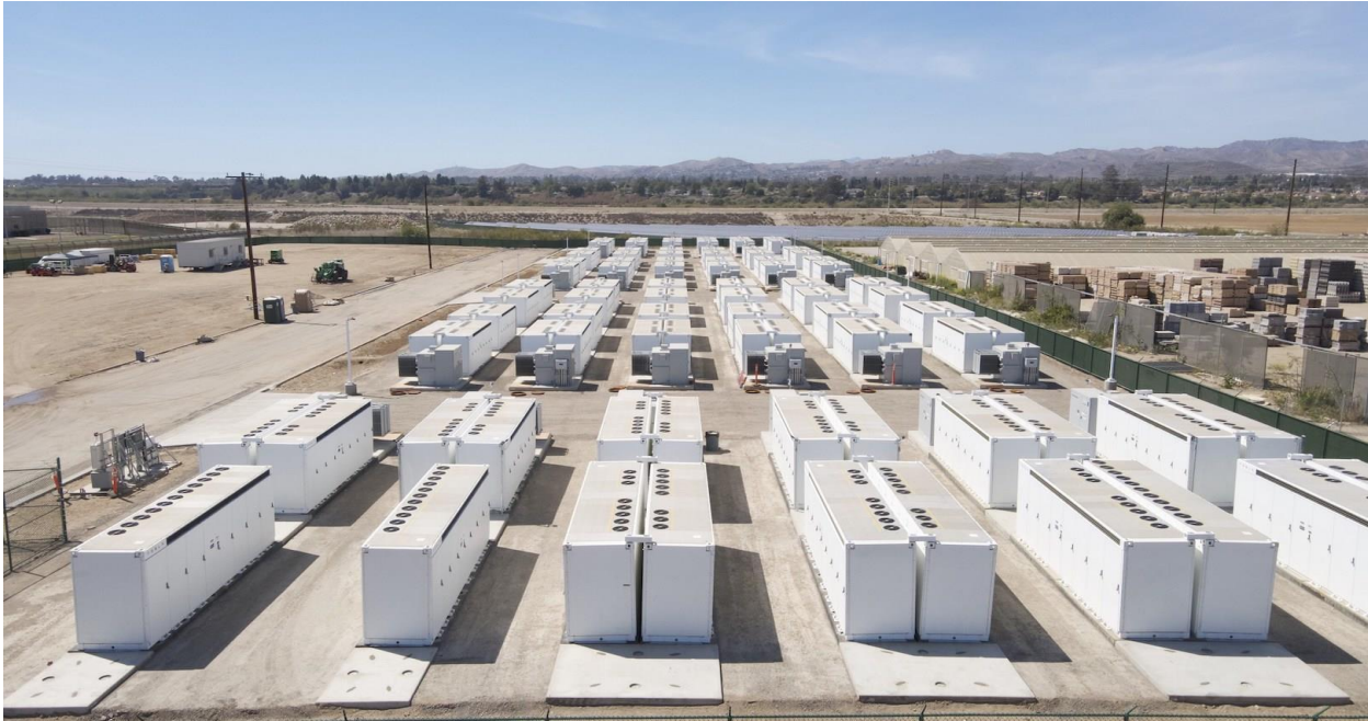
Εικόνα 3. Μονάδα αποθήκευσης της TESLA 100MW/400MWh βασισμένο στο Tesla Megapack. (Πηγή: Image: Arevon Asset Management.)
