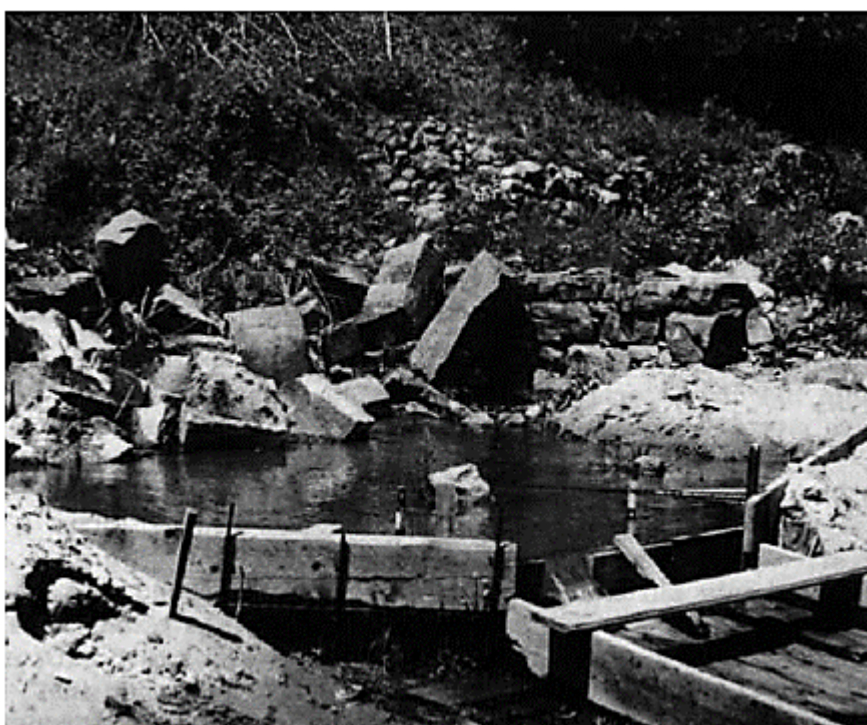
Σχήμα 2.1 Φράγμα για τη μέτρηση της διαρροής κατάντη του φράγματος ισχύος
