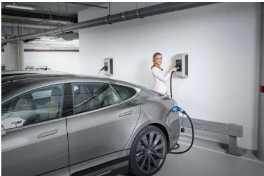
Εικόνα 10: Φορτιστής Level 3 τύπου wall-box (Enervek - recharge.gr, 2020)
