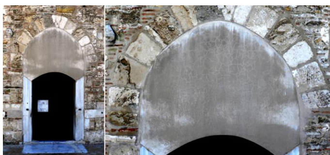
Εικόνα 90. ΒΑ όψη: είσοδος Πύργου, εξανθήσεις αλάτων.
