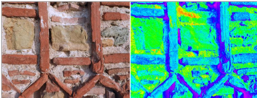
Εικόνα 106. Δ όψη: Οπισθοχώρηση επιφάνειας, επικαθίσεις. Φυσική & επεξεργασμένη εικόνα.
