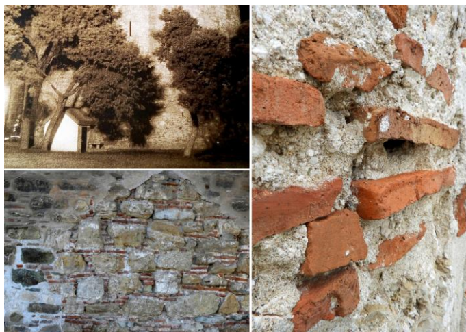
Εικόνα 93. Δ-ΝΔ όψη: Νέα υλικά. Απόσπαση κόκκων κονιάματος, οπισθοχώρηση επιφάνειας, απόξεση πλίνθων.
