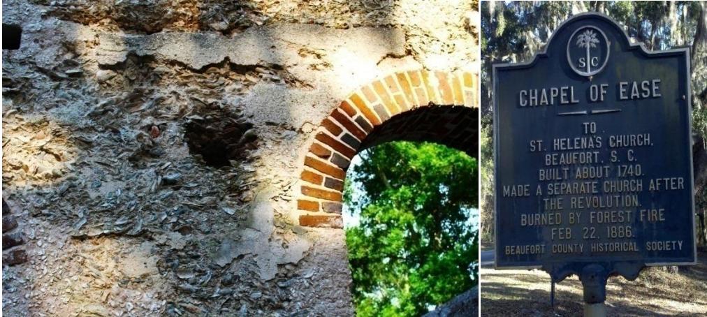
Εικόνα 7. Κατασκευή τοίχου με την μέθοδο Tabby στην Αγγλικανική Εκκλησία της St Helena Parish Chapel of Ease (Πηγή: https://southcarolinalowcountry.com/st-helenas-lands-end-road/ )
