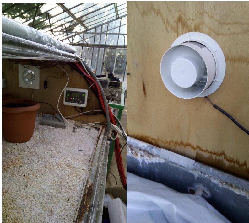
Εικόνα 2.1 Αισθητήρας υγρασίας - Εικόνα 2.2 - Ανεμιστήρας
