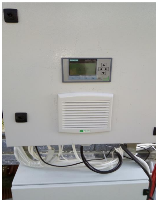
Εικόνα 2.3. Πίνακας ελέγχου των ηλεκτρολογικών.
