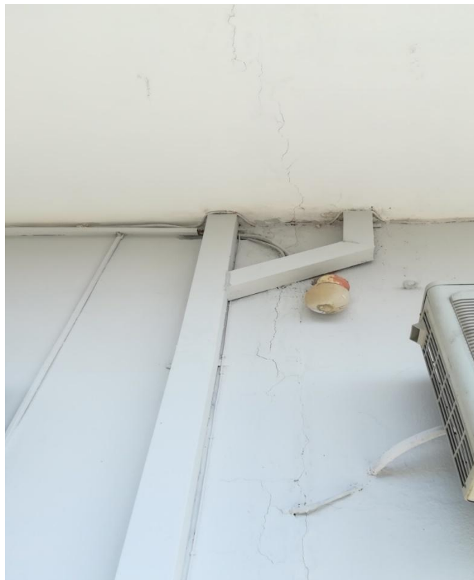
Εικόνα 10: Ρωγμή στο κτίριο του Αστυνομικού τμήματος Που επεκτείνεται και στην πλάκα της οροφής
