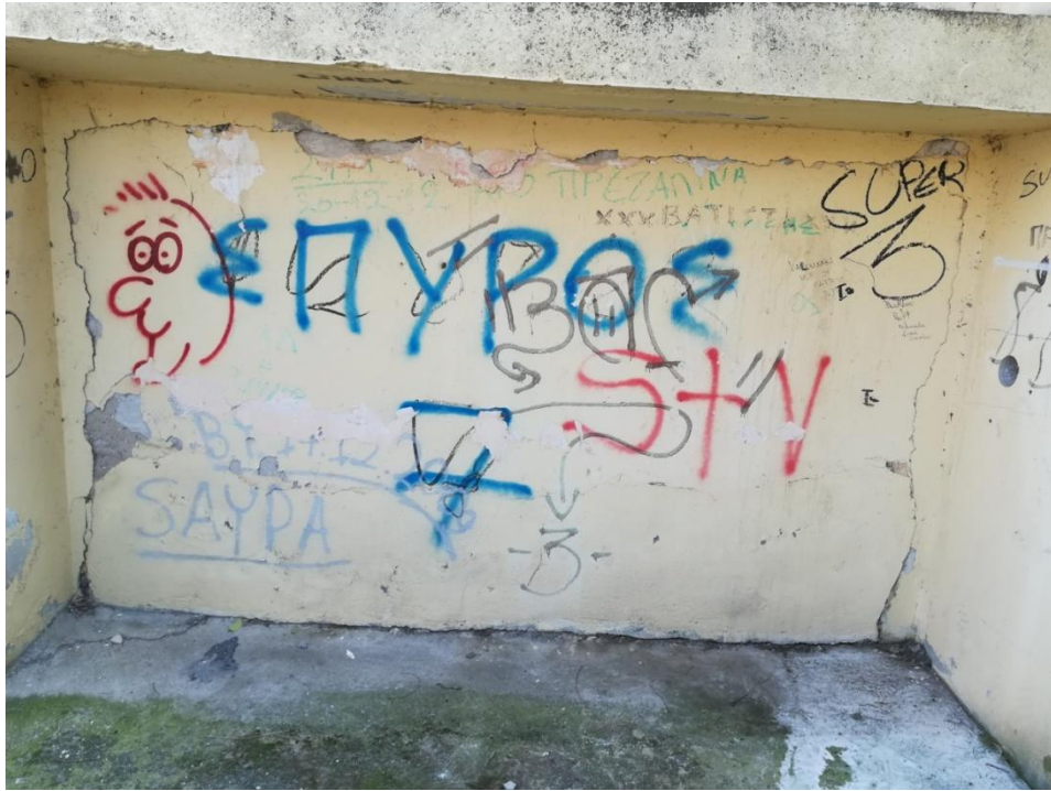
Εικόνα 13: Ρωγμές στην οπίσθια όψη του κτίριο του Αστυνομικού τμήματος
