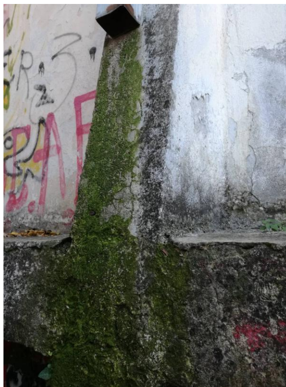
Εικόνα 18: Έντονα φαινόμενα διάβρωσης στο σκυρόδεμα αντηρίδας στην οπίσθια όψη
