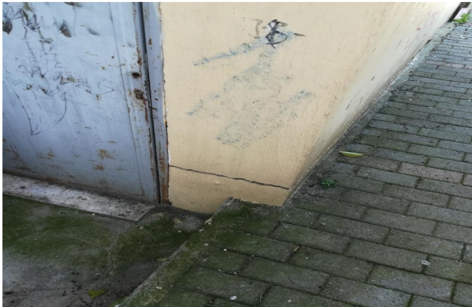
Εικόνα 14: Καθίζηση στην οπίσθια όψη του κτίριο του Αστυνομικού τμήματος
