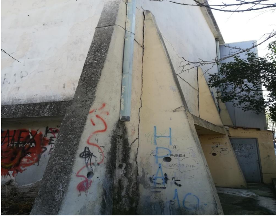
Εικόνα 15: Ρωγμές σε αντηρίδες στην πλαϊνή όψη
