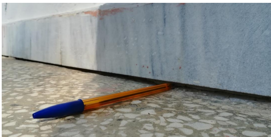
Εικόνα 8: Καθίζηση ορατή στην ένωση μπαλκονιού – τοίχου
