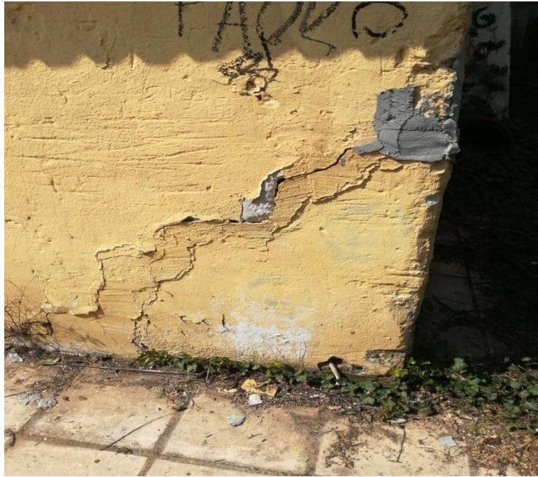
Εικόνα 11: Ρωγή στην πλάγια όψη του κτίριο του Αστυνομικού τμήματος
