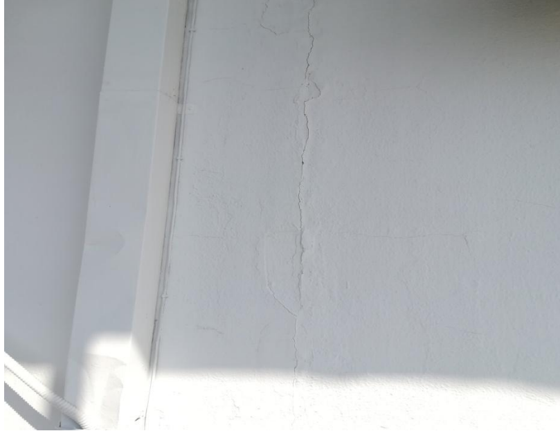
Εικόνα 9: Ρωγμή στο κτίριο του Αστυνομικού τμήματος
