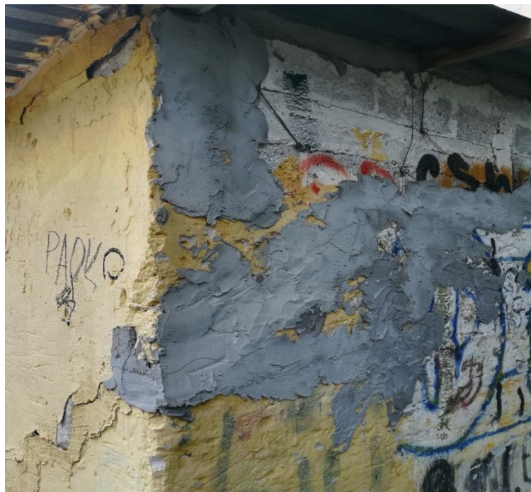
Εικόνα 12: Μερικώς επισκευασμένες ρωγμές στην πλάγια και οπίσθια όψη του κτίριο του Αστυνομικού τμήματος
