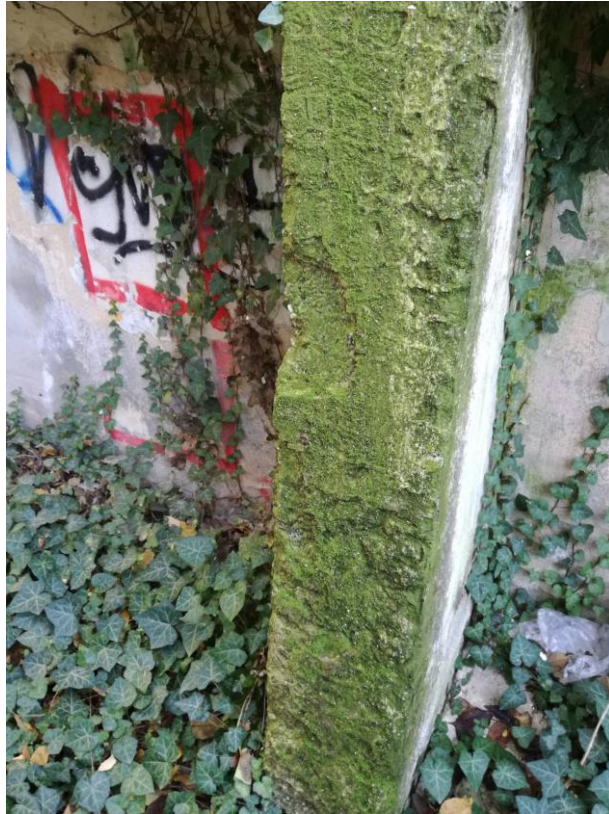
Εικόνα 19: Έντονα φαινόμενα διάβρωσης στο σκυρόδεμα αντηρίδας στην οπίσθια όψη
