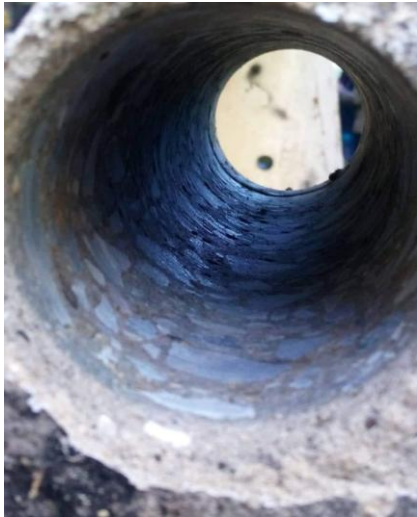
Εικόνα 27: Δομή σκυροδέματος μετά την συγκομιδή πυρήνα
