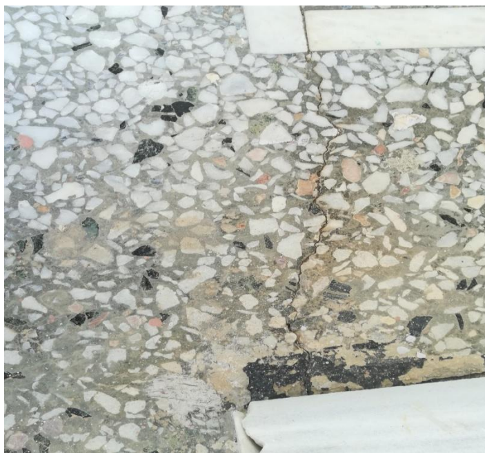
Εικόνα 7: Ρωγμή στο πάτωμα του μπαλκονιού
