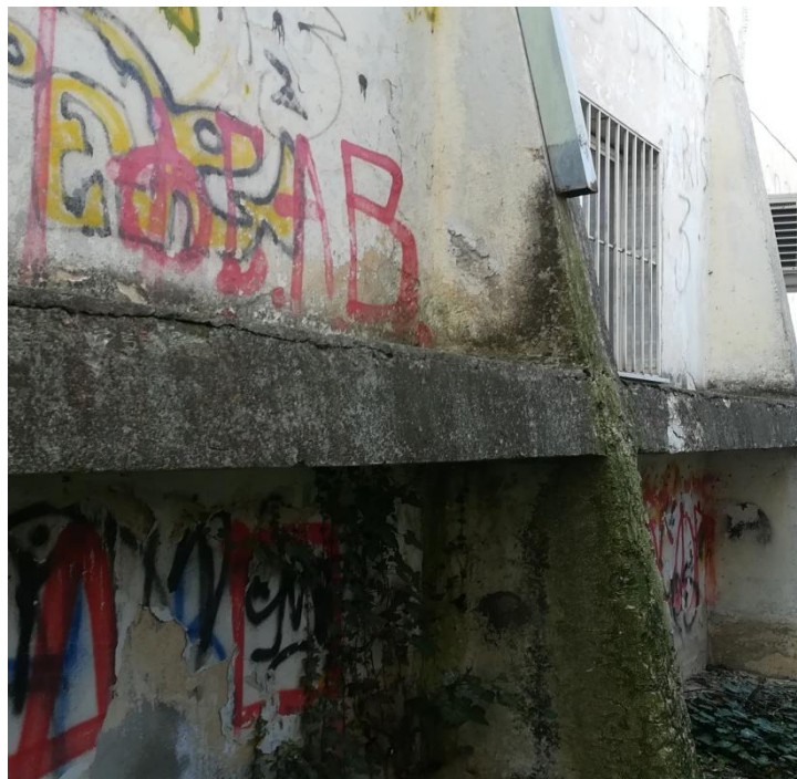
Εικόνα 17: Έντονα φαινόμενα διάβρωσης στο σκυρόδεμα αντηρίδας στην οπίσθια όψη
