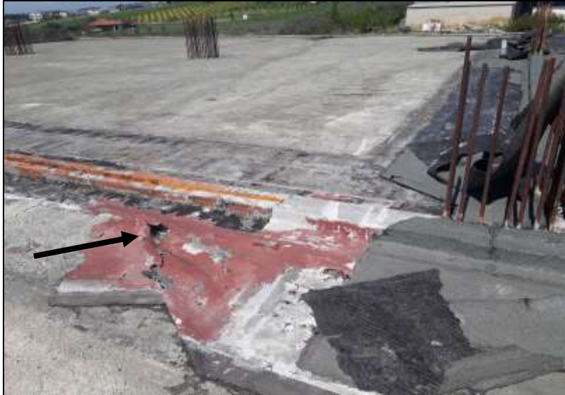
Εικόνα 29 φθορές στον αρμό
