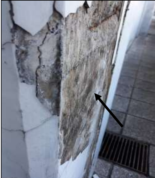
Εικόνα 23 Απώλεια επικάλυψης, διόγκωση οπλισμού και ρωγμές
