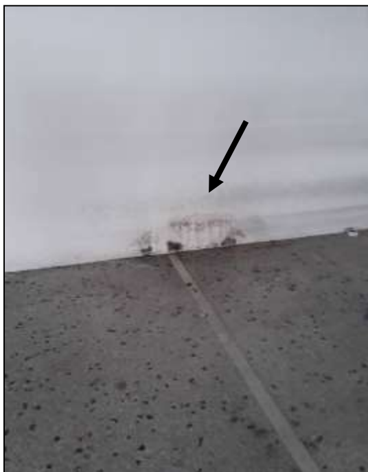
Εικόνα 13 Υγρασία στο τοιχίο
