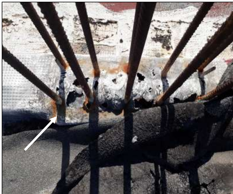
Εικόνα 28 Σοβαρή διάβρωση του οπλισμού
