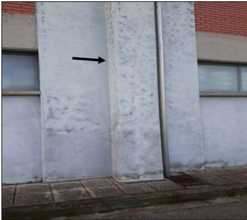
Εικόνα 18 Επίδραση απορροής νερού στο υποστύλωμα
