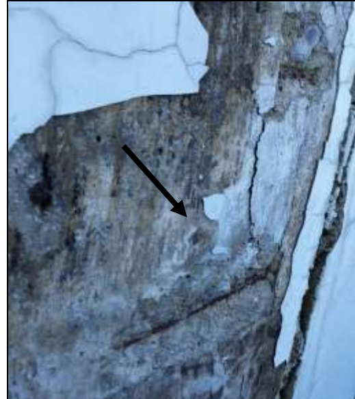
Εικόνα 24 Απώλεια επικάλυψης, διόγκωση οπλισμού και ρωγμές
