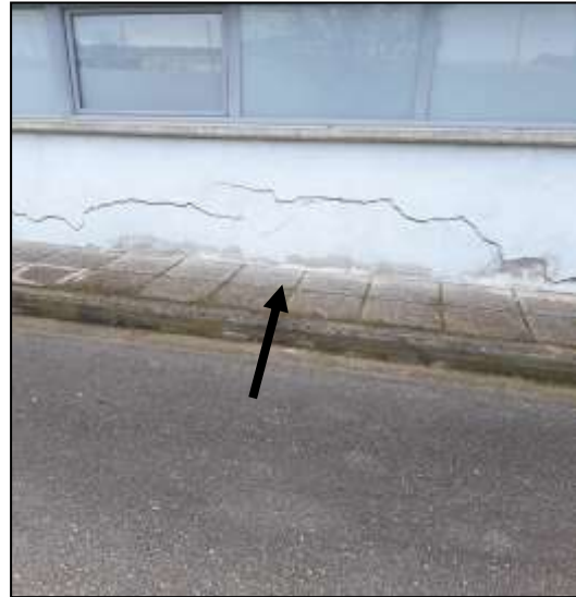
Εικόνα 20 Ρωγμή στο τοίχιο λόγω καθίζησης
