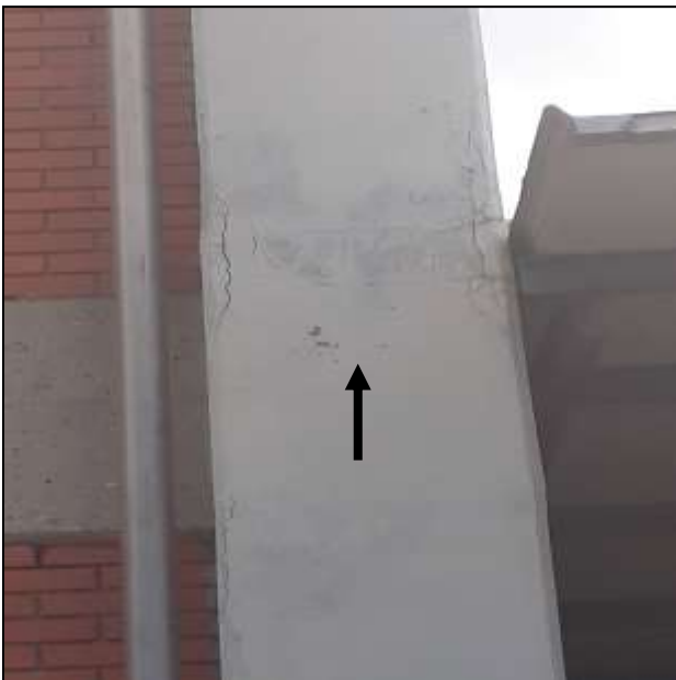
Εικόνα 21 Ρωγμές από θερμοκρασιακές μεταβολές στο υποσύτλωμα
