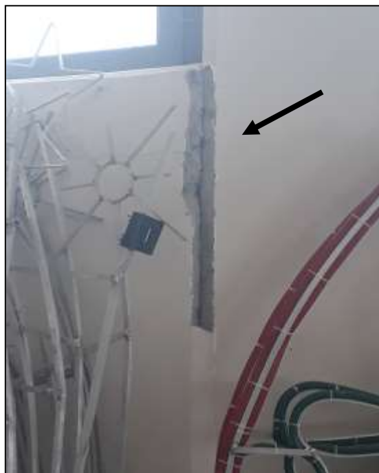
Εικόνα 14 Ρωγμή στην σύνδεση τοιχίου - υποστυλώματος
