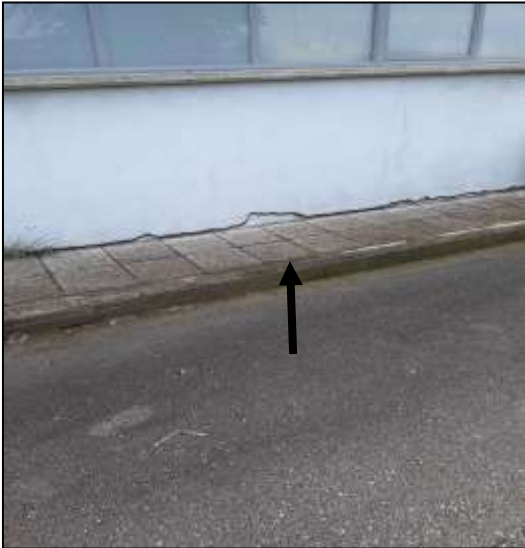
Εικόνα 19 Ρωγμή στο τοίχιο λόγω καθίζησης
