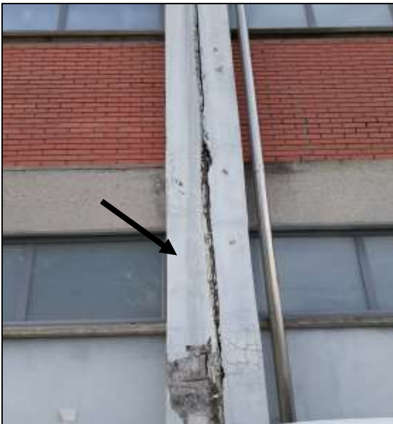
Εικόνα 25 Ρωγμή και οξείδωση οπλισμού στο υποστόλωμα
