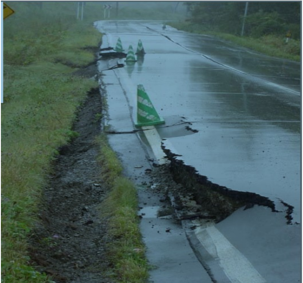
Εικόνα 2.15: Αστοχία του δρόμου στην περιοχή Hokkaido στην Ιαπωνία, το 2003.
