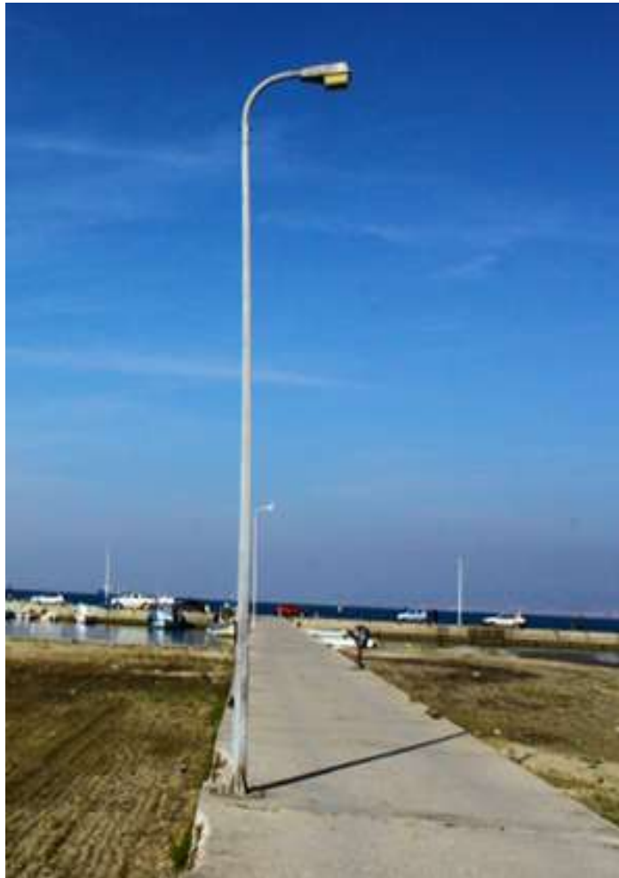
Εικόνα 18 : Χαλύβδινος ιστός φωτισμού της προβλήτας (05-05-2017)
