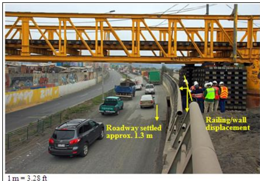
Σχήμα 2.13 Καθίζηση σε τοίχο αντιστήριξης και στο οδικό δίκτυο λόγω ρευστοποίησης του εδάφους μετά το σεισμό στη Χιλή (2010) (από U.S. Department of Transportation).
