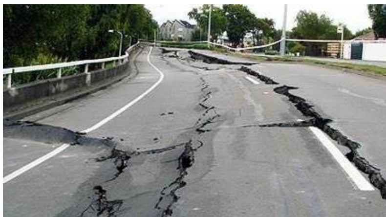
Σχήμα 2.11 Καταστροφές στο οδικό δίκτυο λόγω ρευστοποίησης που προκλήθηκε από το σεισμό στο Christchurch της Νέας Ζηλανδίας (2011).
