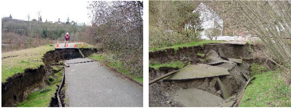
Σχήμα 2.12 Αστοχία επιχωμάτων ως αποτέλεσμα ρευστοποίησης κατά το σεισμό Nisqualli στην Ουάσινγκτον (2001).
