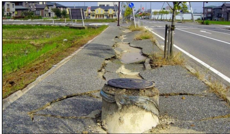
Σχήμα 2.10 Ανύψωση φρεατίου μετά τη ρευστοποίηση που προκλήθηκε από το σεισμό της Niigata στην Ιαπωνία το 2004.
