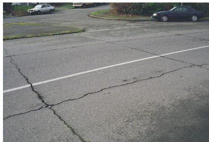
Εικόνα 2.4: Ρωγμές από ανάκλαση
