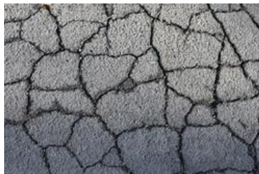
Εικόνα 2.1: Ρωγμές τύπου αλιγάτορα (Πηγή: www.prestige-sealcoating.com )
