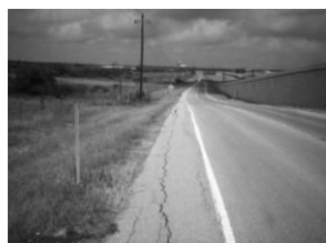
Εικόνα 2.2: Ρωγμές στα άκρα του οδοστρώματος (Πηγή: www.asphaltinstitute.org )
