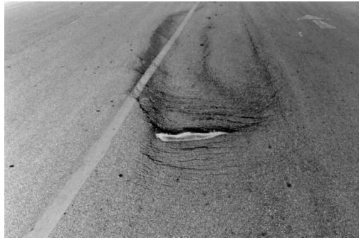
Εικόνα 2.5: Ρωγμές από ολίσθηση ταπήτων
