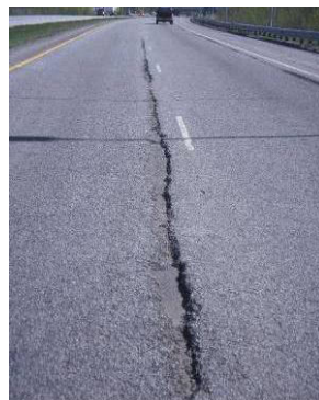
Εικόνα 2.3: Ρωγμές μεταξύ των λωρίδων διάστρωσης ή διαπλάτυνσης
