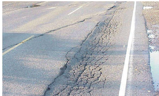
Εικόνα 2.7: Ρωγμές στην τροχιά των τροχών
