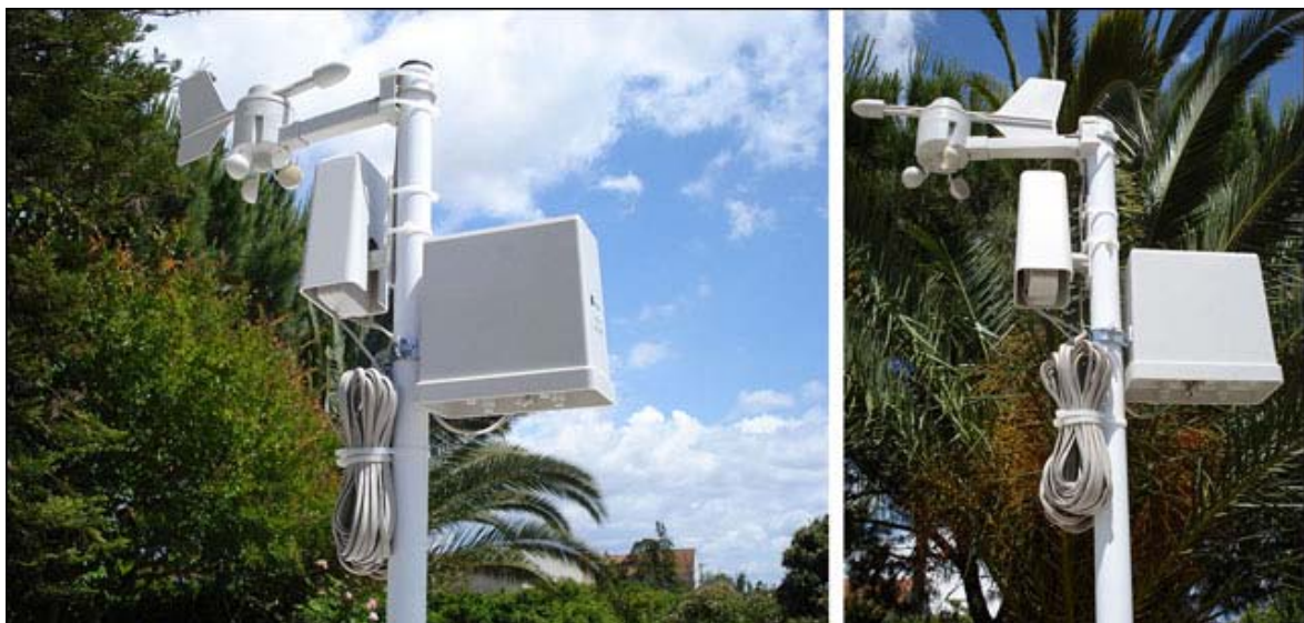
Σχήμα 2.15 Τυπική εγκατάσταση μετεωρολογικού σταθμού WS-2350
