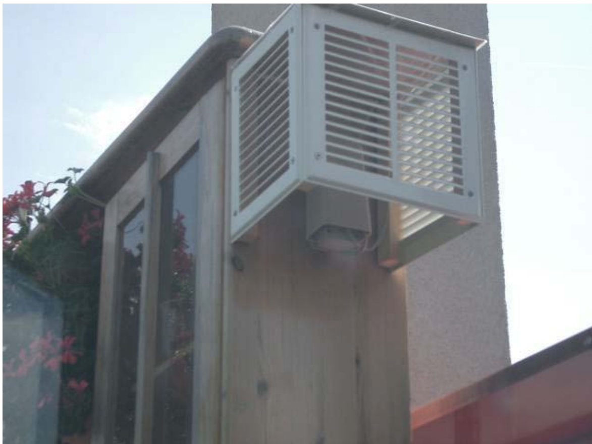
Σχήμα 2.13 Τοποθέτηση αισθητήρα θερμοκρασίας υγρασίας
