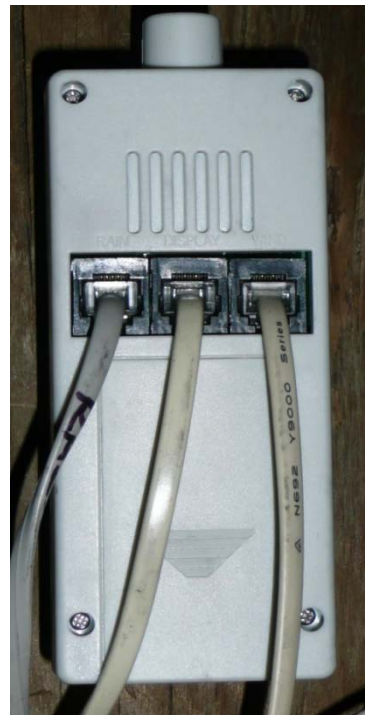
Σχήμα 2.3 Καλωδιακή σύνδεση αισθητήρα θερμοκρασίας – υγρασίας
